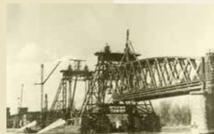
Wiederaufbau der Brücke während des Krieges, 1940. Kreisarchiv Rastatt, Sammlung Hermann Stimmler Reconstruction du pont pendant la guerre, 1940. Archives du district de Rastatt, collection d'Hermann Stimmler
