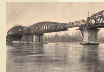
Der mittlere Brückenbogen wird installiert, 1949. Kreisarchiv Rastatt, Le Metier, 2/1949 Installation de l'arche centrale, 1949. Archives du district de Rastatt, Le Metier, 2/1949
