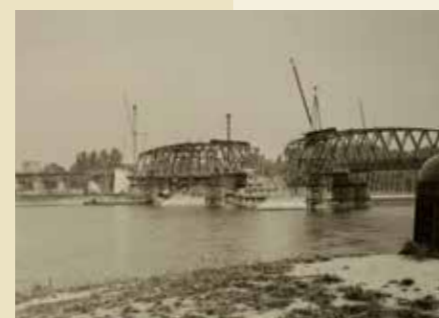
Mit den Kranbrücken wurden die Brückenbogen in Position gebracht, 1941. Kreisarchiv Rastatt, Sammlung Dr. Johannes Werner Les ponts de grue permirent de mettre les arches en position, 1941. Archives du district de Rastatt, collection de Johannes Werner
